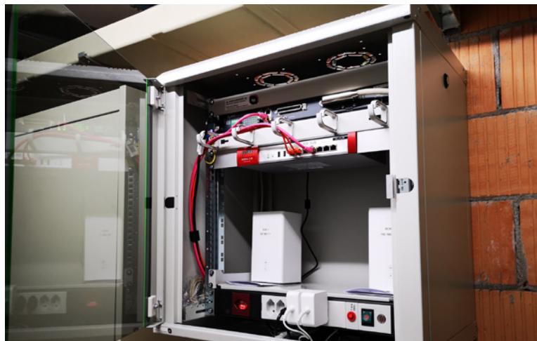
So sieht ein kleiner Teil der verbauten Technik aus.
