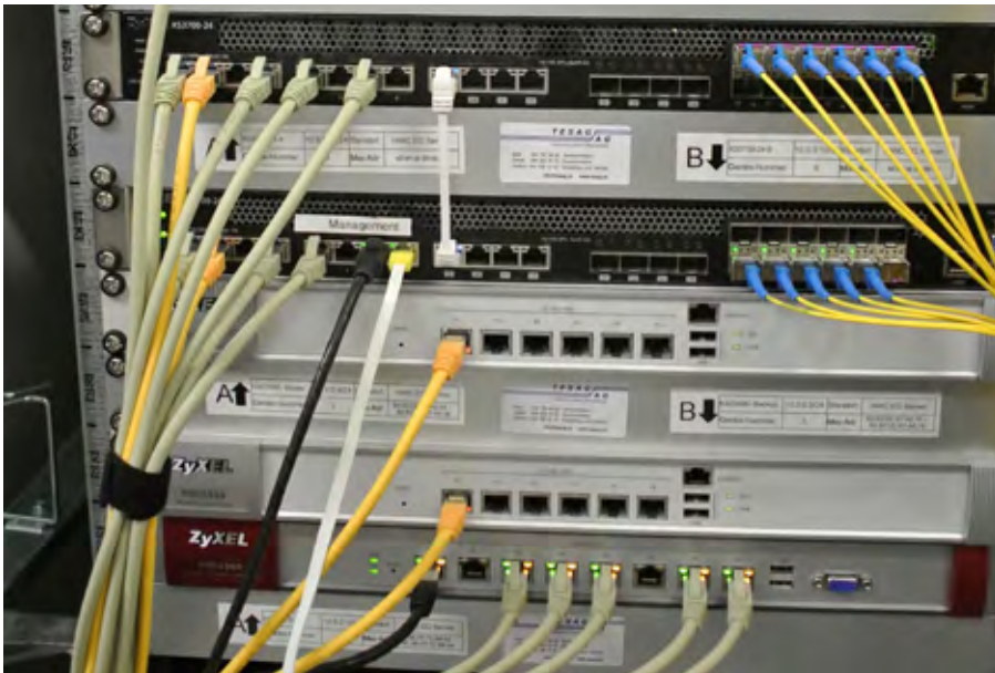
Viele Kabel für kabelloses Surfen: Netzwerkkomponenten im Serverraum.
