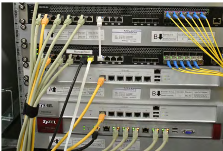
Beaucoup de câbles pour surfer sans fil : des composants du réseau dans la salle de serveurs
